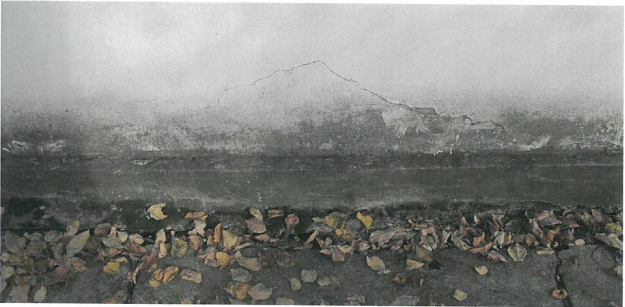
Eflorescențe și expulzarea tencuielilor la nivelul soclului, fisuri, crăpături
