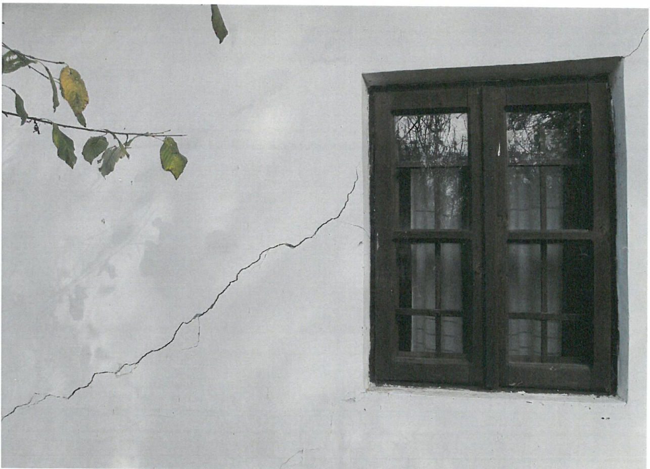
Fisuri și crăpături pereți exteriori – fațada posterioară
