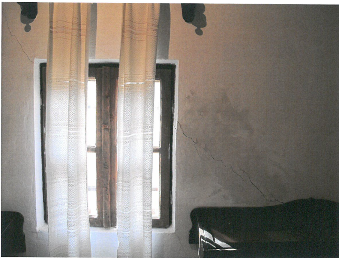
Fisuri și crăpături, desprinderi de tencuială la pereți interiori
