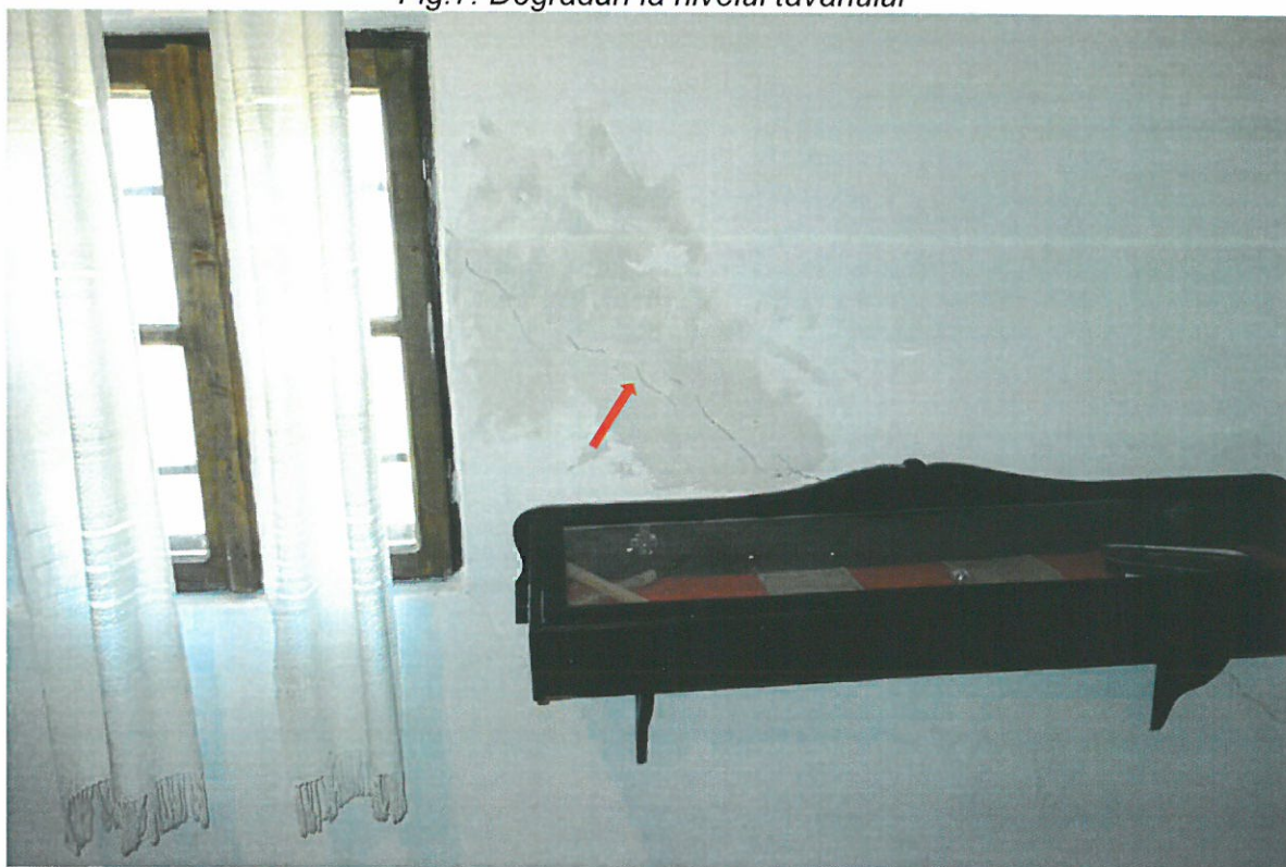
Fig.8: Fisuri (se observă o serie de lucrări de natură recentă)
