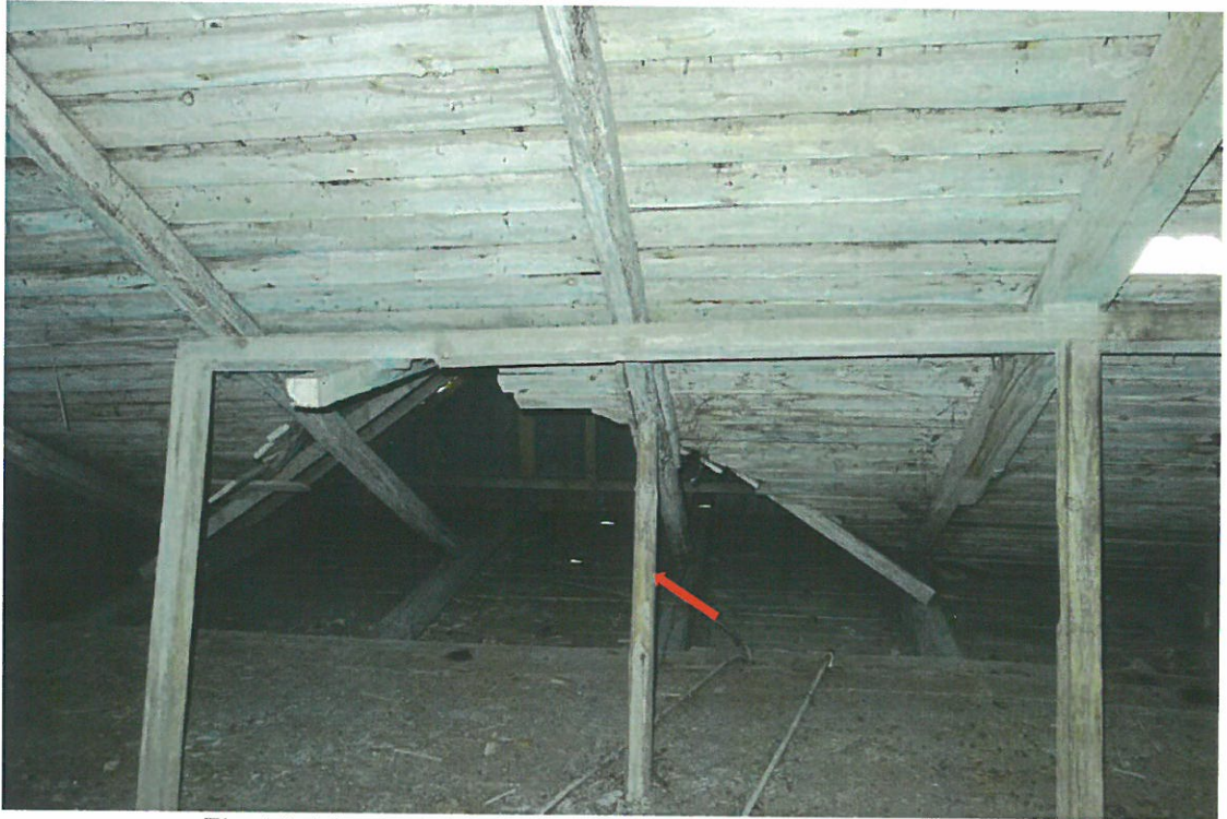
Fig.13: Elemente necarosate degradate – șarpantă lemn
