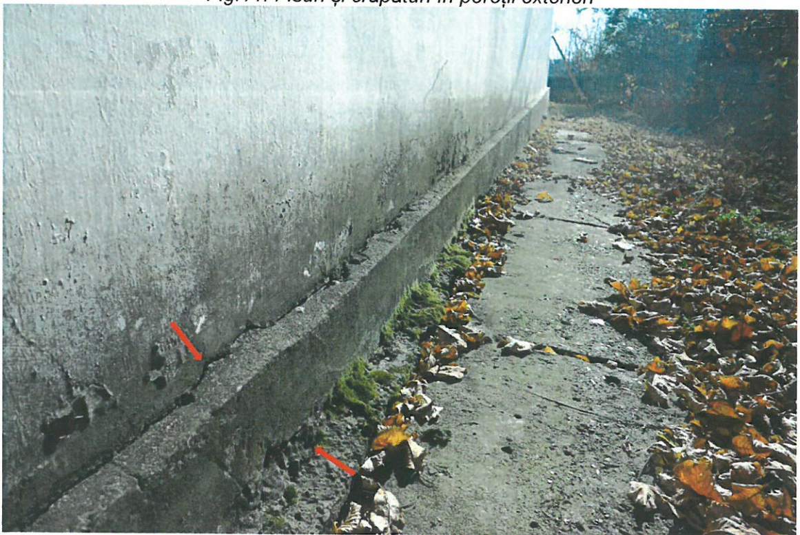
Fig.12: Degradări, fisuri și crăpături la nivelul soclului și a tencuielilor exterioare
