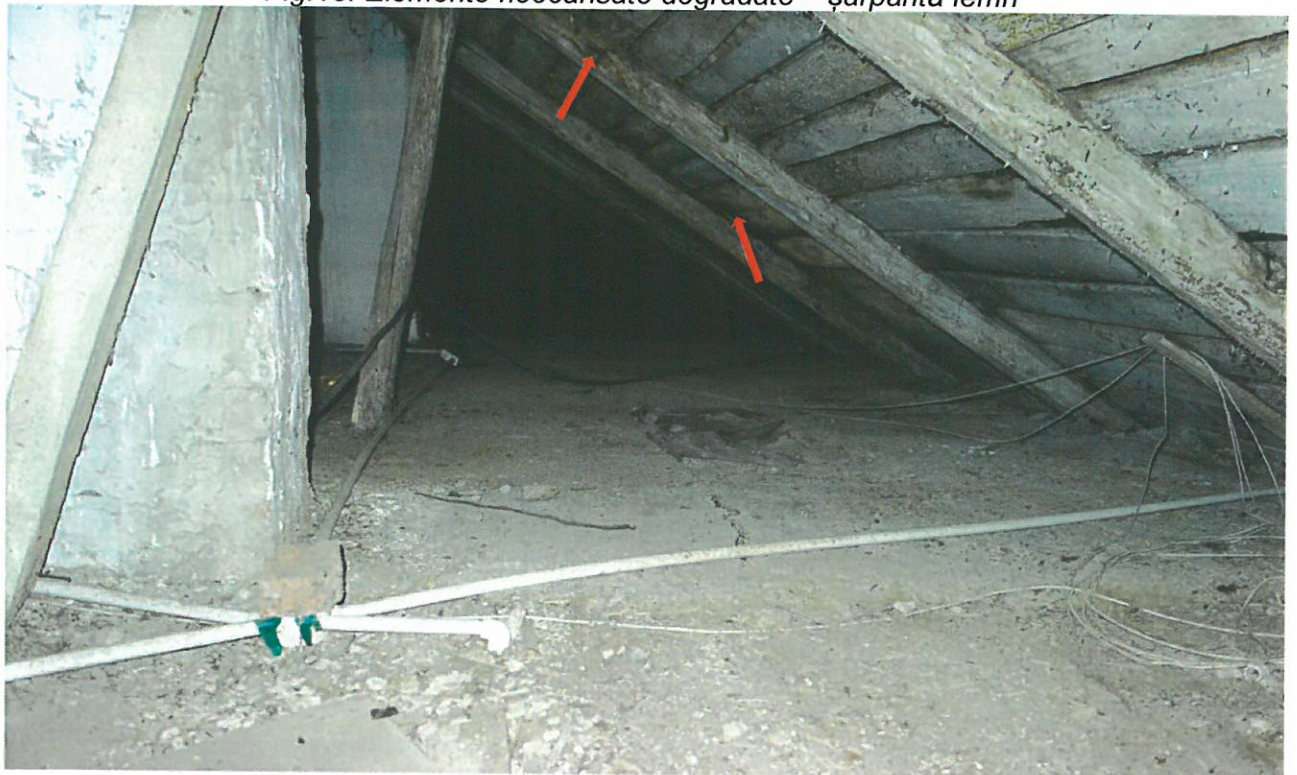
Fig.14: Infiltrații de apă la nivelul podului și a asterealei
