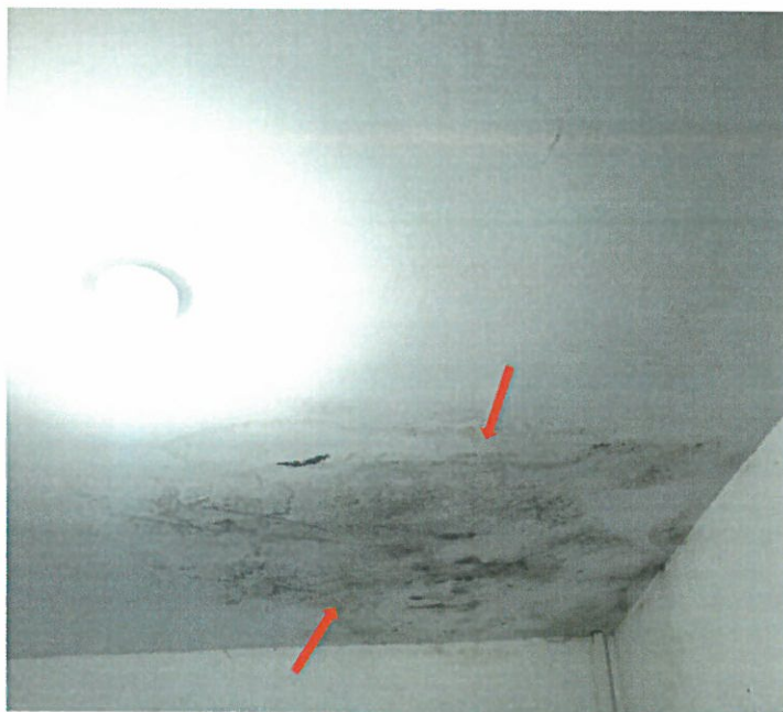
Fig.7: Degradări la nivelul tavanului
